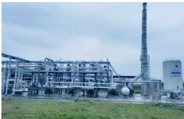
新迪生物废气治理提升项目
