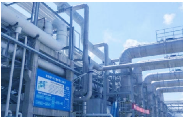
川宁生物生产工艺废气处理设备
