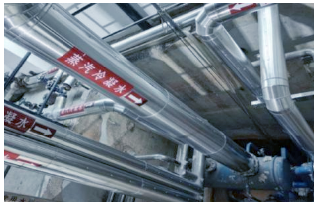
岳阳分公司: 蒸汽冷凝水回收使用项目
